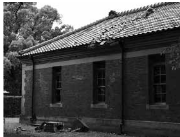
化学実験棟の崩落した煙突部
