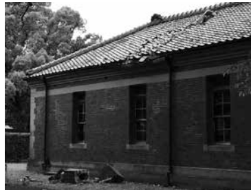
化学実験棟の崩落した煙突部
