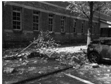
五高記念館裏側の崩落した煙突
